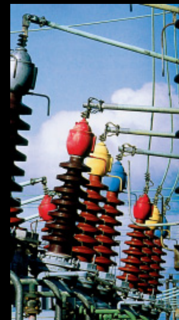
发电厂的高压变电器
